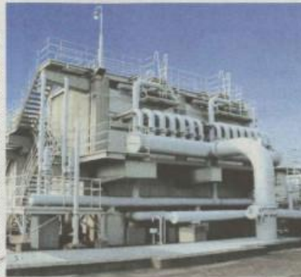
世界の主流となっているORV (LNG気化装置)
